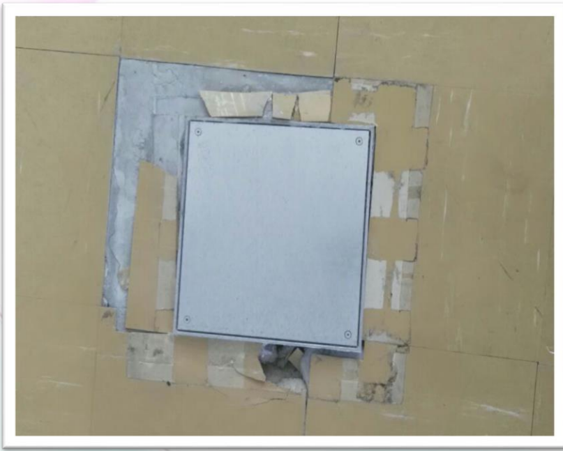
Penemuan: Lantai rusak dan berlubang
